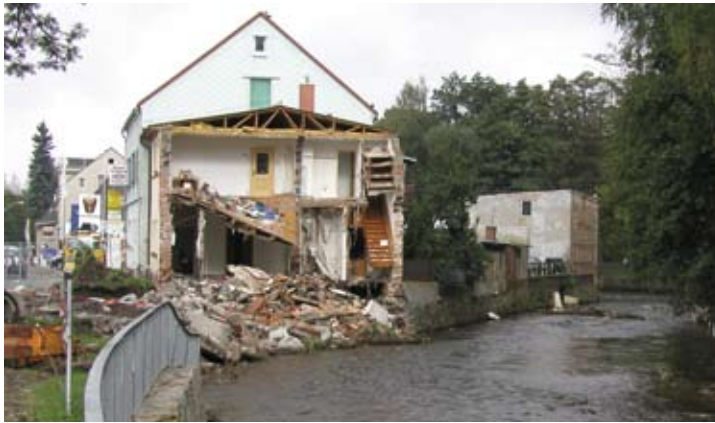
→ ABB. 9 Durch das Hochwasser 2002 zerstörtes Wohnhaus an der Flöha
