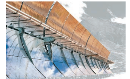
Die Sonne nutzen: Parabolrinnenanlage in Almeria
